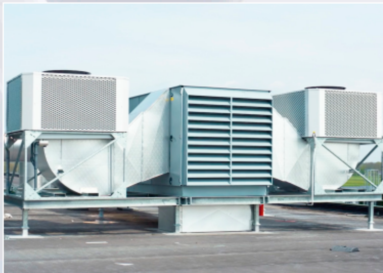
Due Intracool installati ad un UTA, Olanda
